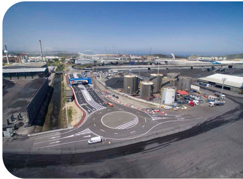
Vista aérea de toda la actuación (junio 2021). Aerial view of the works (June 2021).
