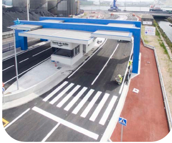
Caseta de control de accesos y pórtico (abril 2021). Access control booth and portal (April 2021).
