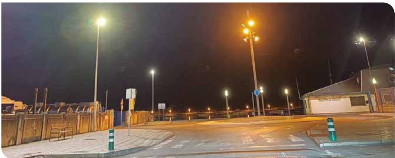
Vista del alumbrado público con tecnología led en zona de prácticos. Public lighting with LED technology in the pilot area
